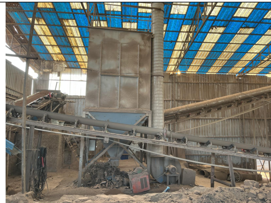
图 3 破碎、筛分车间损坏的废气治理设施
